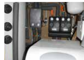
Die Haustechnikzentrale: Wärmepumpe plus Pufferspeicher.
